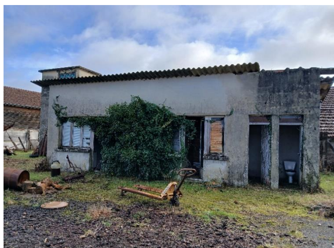
Figure 75 Bâti délabré sur une ancienne friche artisanale (friche des ruches)
