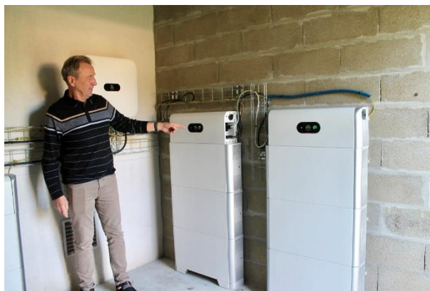
Figure 12 Batterie pour stocker l'électricité ©Yannick Revel-Reporterre
